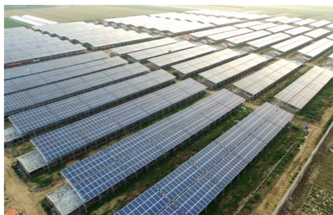
60MW 山东潍坊畜光互补光伏项目
