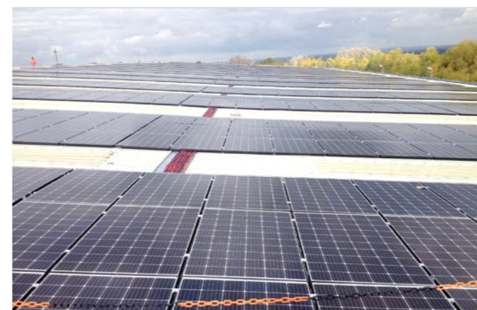
3.8MW 英国利物浦分布式光伏项目
