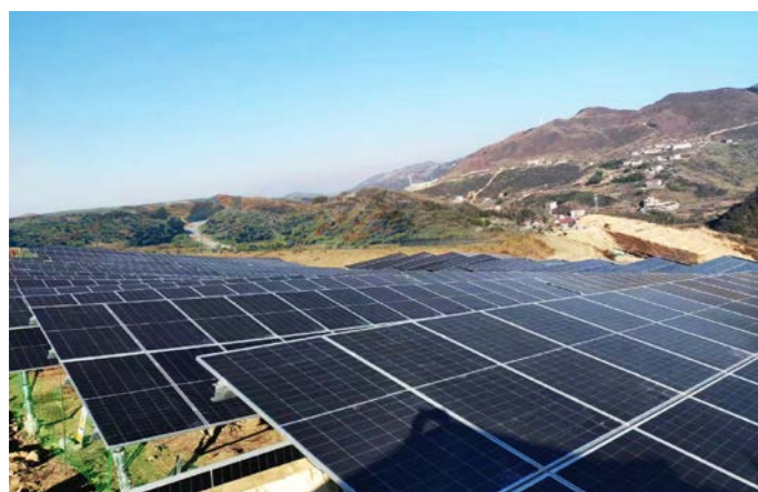
120MW 湖南冷水江山地光伏项目
