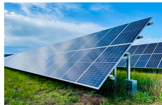
12.3MW 澳洲墨尔本机场地面光伏项目
