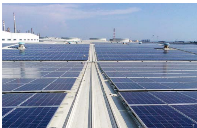
24MW 海南儋州分布式光伏项目
