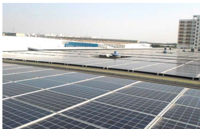
35MW 广东广州屋顶光伏项目
