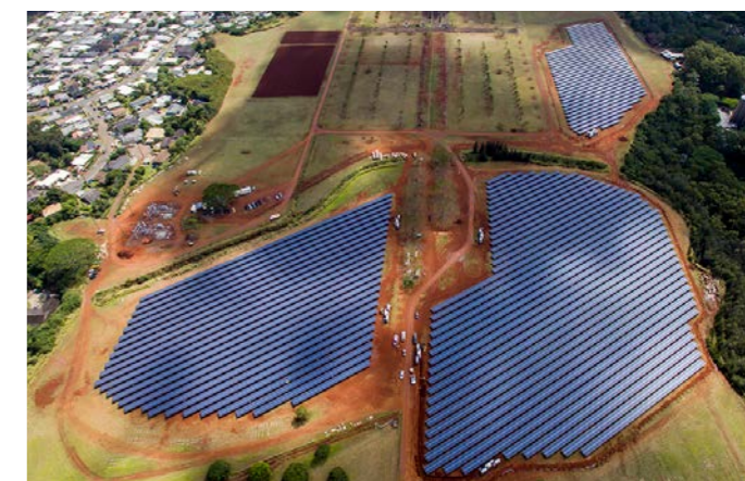
7.6MW 美国夏威夷地面光伏项目
